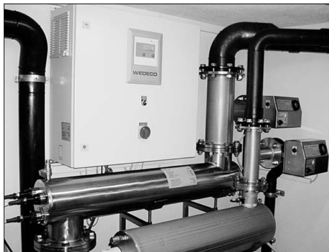
Aufbereitungsanlagen (waagrecht) und Verwurfsklappen rechts im Hintergrund.
